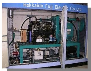
ガス発電機内部
